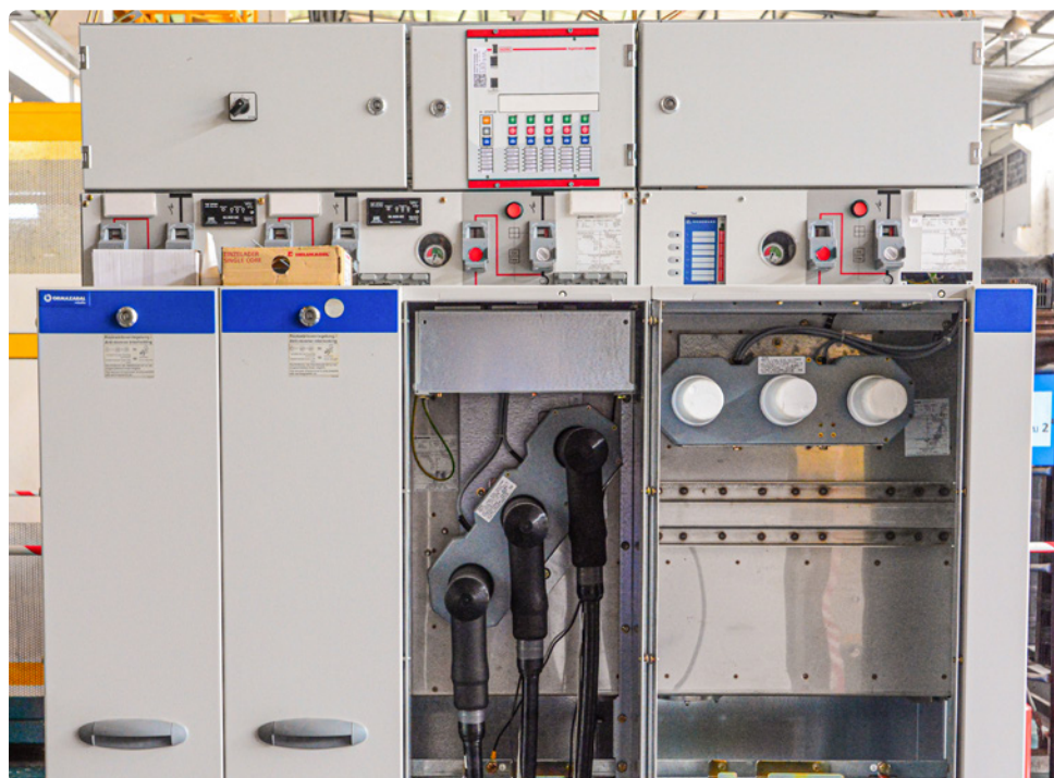
Automatización de RMU
