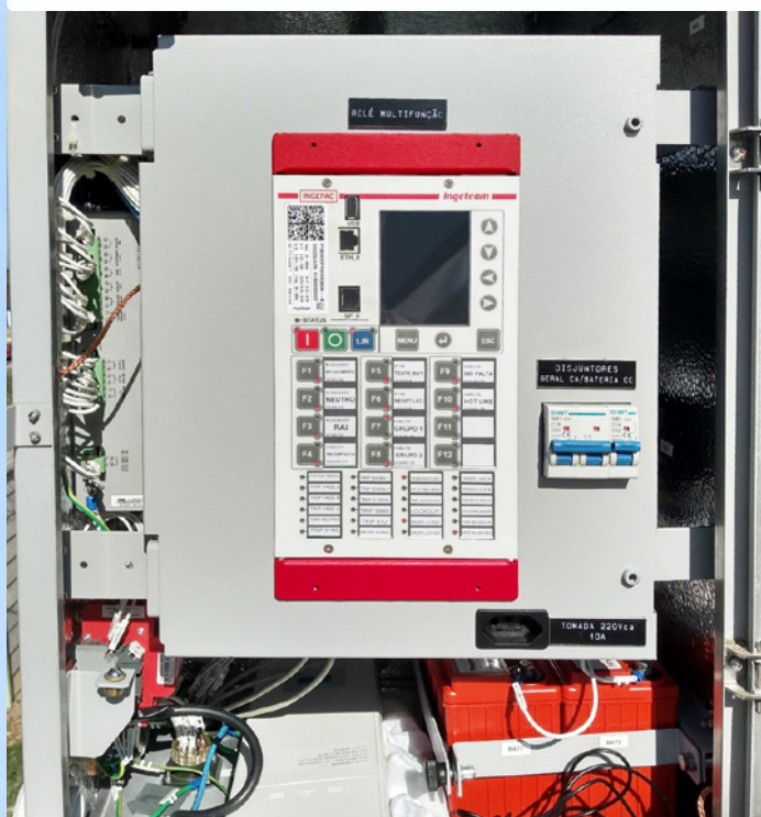
INGEPAC DA PT instalado en armario
