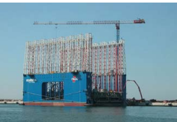
DIQUE FLOTANTE KUGIRA MODERNIZACIÓN PLANTA ELÉCTRICA Y AUTOMATIZACIÓN SISTEMAS DE LASTRE Y DTI
