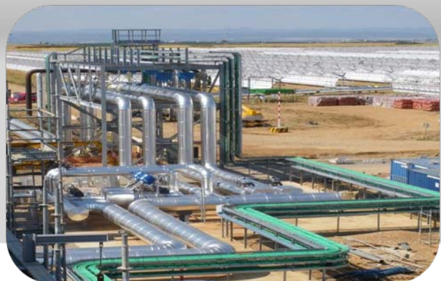
PALMA DEL RÍO - Solar-thermal plant
