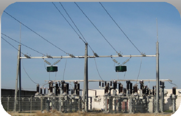
ACIERIE du CENTRE Substation
