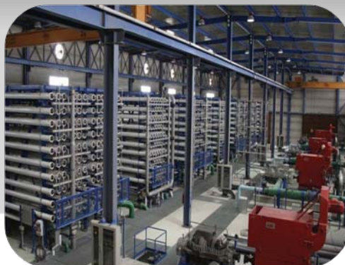
Desalination Plant RAMBLA DE MORALES
