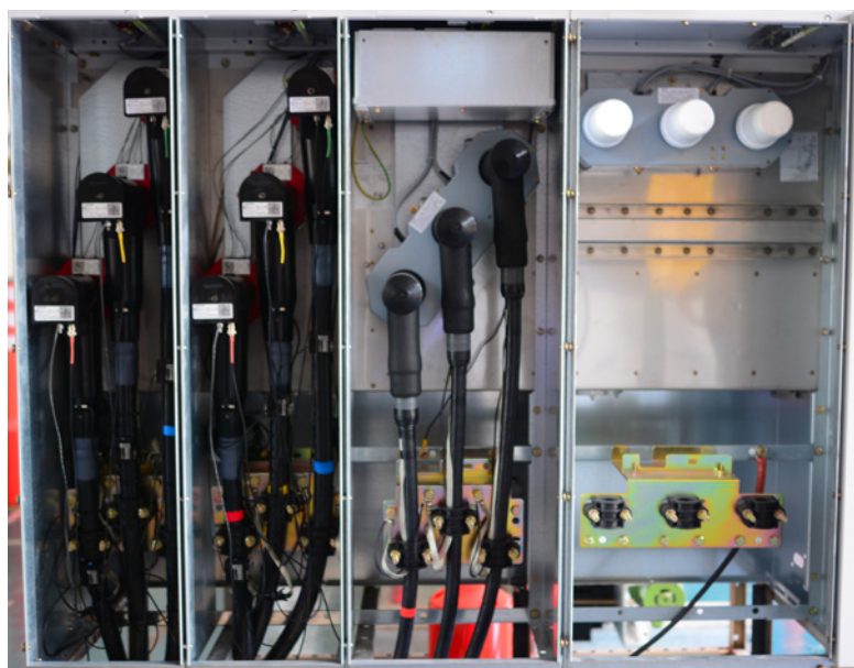
INGEPAC™ SR GR instalados en celdas
