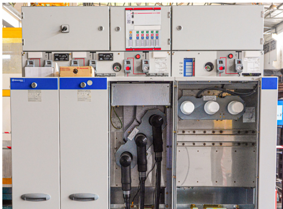
Automatización de RMU
