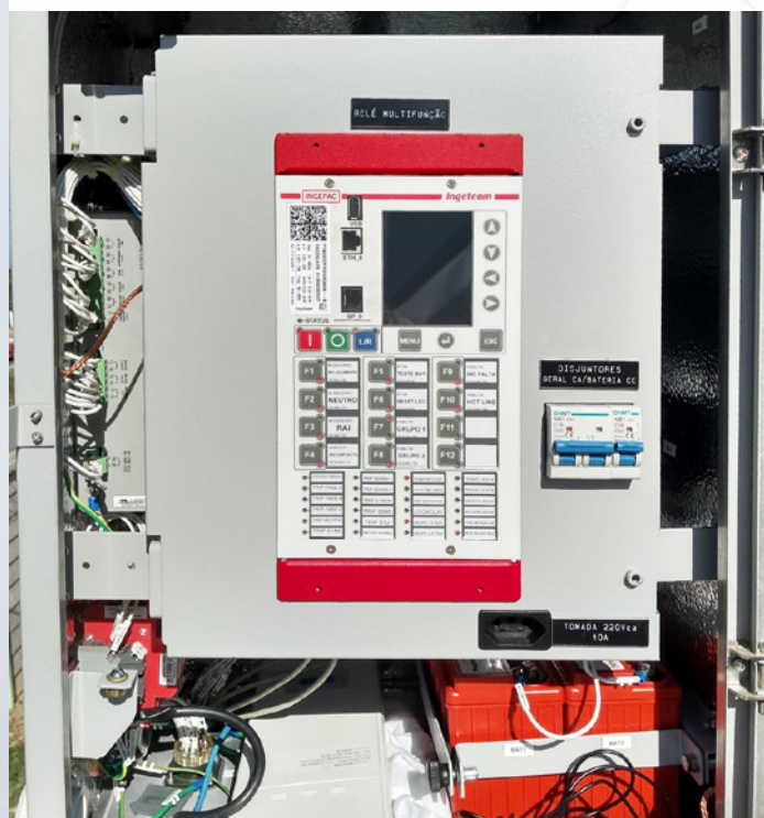
INGEPAC™ DA PT instalado en armario
