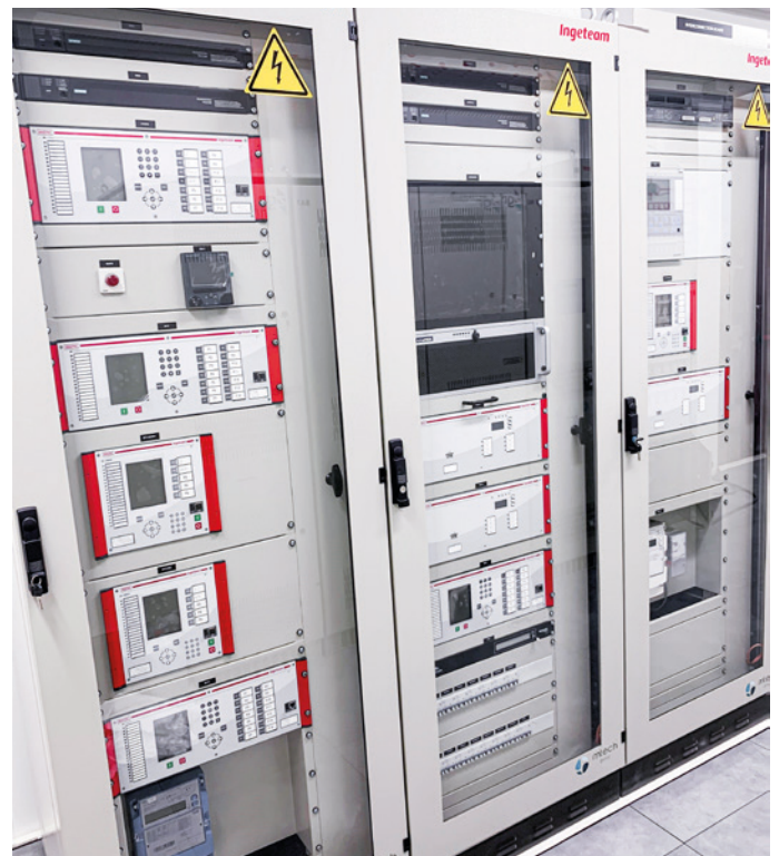
Armarios del sistema de protección y control
