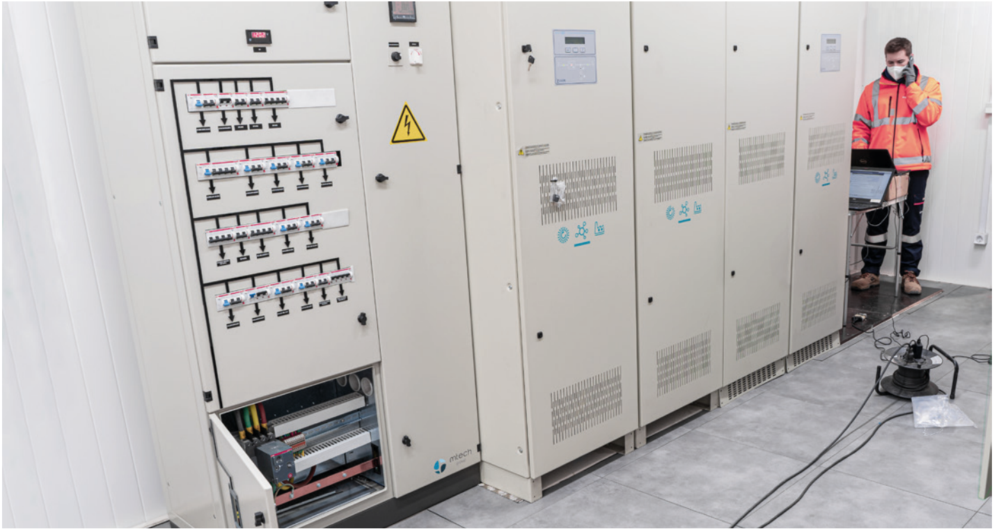
Pruebas de telecontrol
