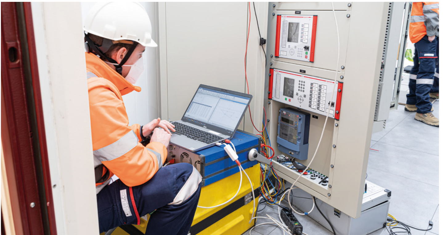
Pruebas de equipos de protección
